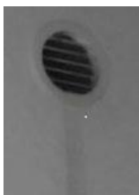
Venkovní mřížka bez uzpůsobení odtoku kondenzátu
